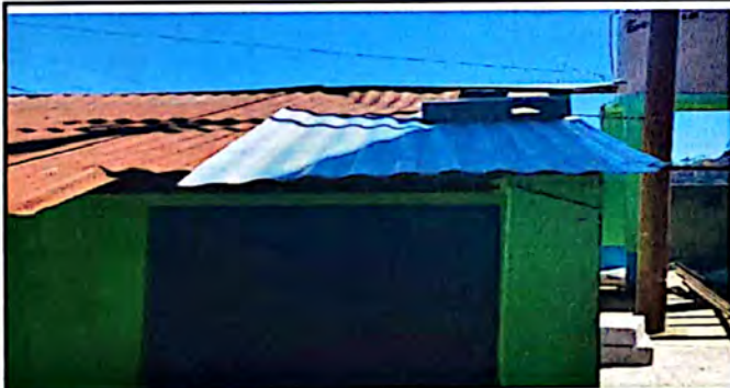
Foto 3 techo en mal estado
