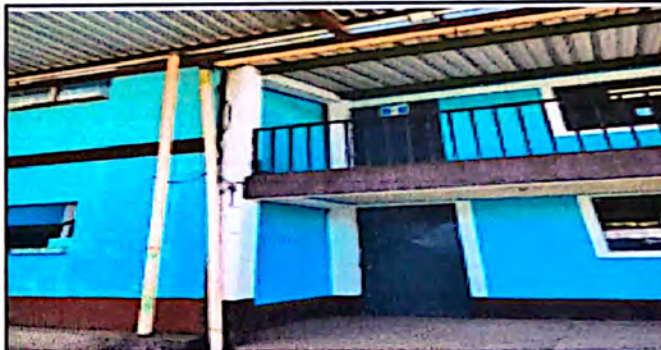
Fto 2 barandas en mal estado.
