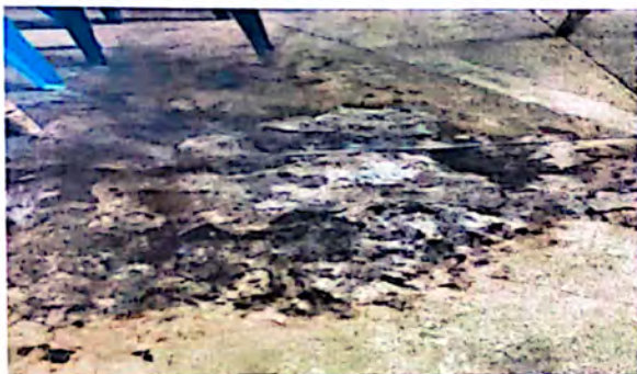
Foto 1 piso en el aula en mal estado.
