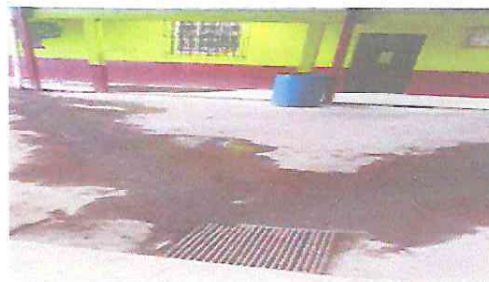
Foto 4: Resultado de las bajadas de agua.
