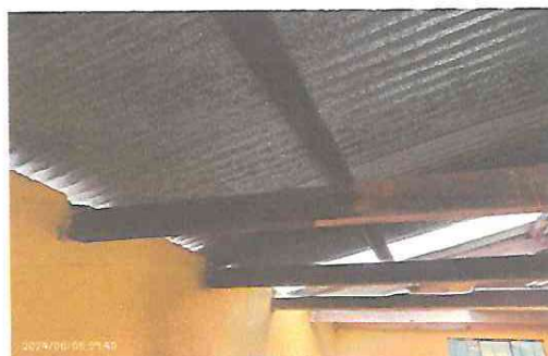
Foto 2: La estructura del techo esta demaciado corroccionada, por polilla y humedad.
