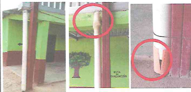
Foto 4: LA bajadas de agua no son adecuadas y se han ido colocando según la necesidad de manera incorrecta.
