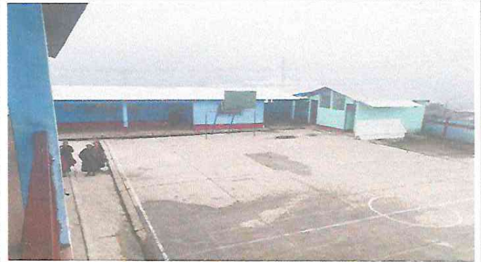
Foto 2: Fotografía del segundo nivel donde se visualiza la falta del techado de lamina
