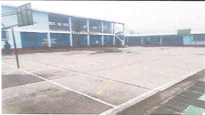
Foto 3: En la fotografía se visualiza la falta de techo de la cancha y afecta en las actividades deportivas, culturales y sociales.
