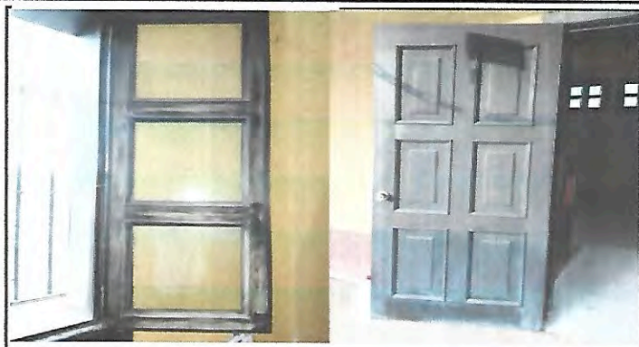
Foto 2: pintura en marcos de ventanas y puertas de madera
