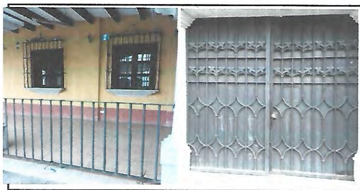
Foto 6: pintura en balcones, barandas y porton de entrada principal
