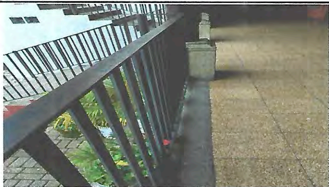
Foto1: Estado actual de barandas de los pasillos que se encuentran con corrosión
