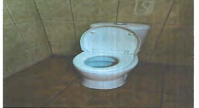
Foto 6: Estado de sanitarios planta baja
