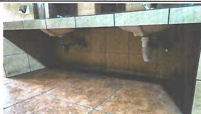
Foto 2: Estado actual de lavamanos planta baja
