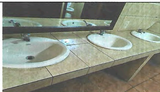
Foto 4: Estado actual de lavamanos planta baja.
