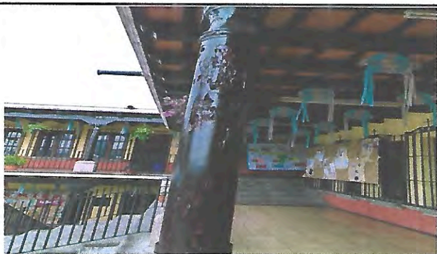
Foto 5: Estado actual de columnas planta alta 2
