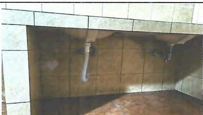
Foto 3: Estado actual de lavamanos planta baja
