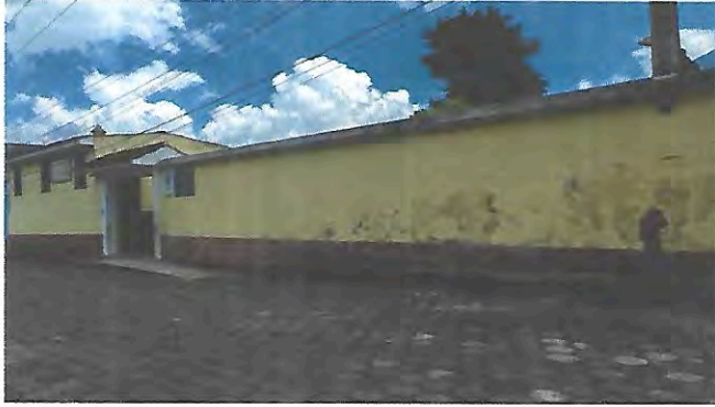
Foto1: Estado actual de pintura de fachada principal
