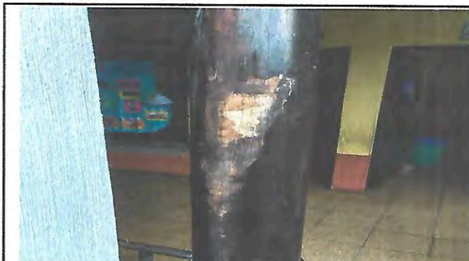
Foto 4: Estado actual de columnas, cerca de dirección
