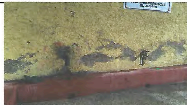
Foto 6: Estado actual de pintura en el establecimiento
