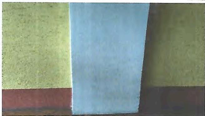
Foto1: Estado actual de pintura en columnas pasillo de pila
