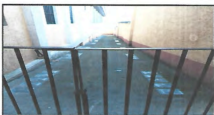
Foto 6: FILTRACIÓN DE RAMPA
