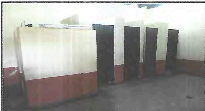
Foto1: Los 9 sanitarios necesitan ser remozados pues constantemente se están cambiando llaves, mangueras, sapitos, etc. Y también presentan fugas, ya que los accesorios no tienen durabilidad.
