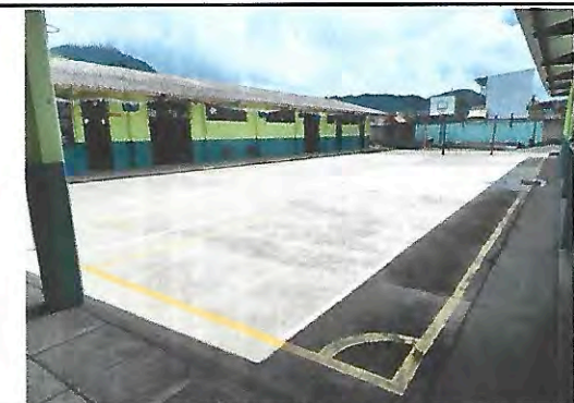
Foto 5: Estado Actual de la esquina de la cancha del lado oeste
