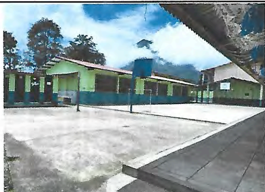
Foto 3: Estado actual de la esquina de la cancha deportiva del lado Este
