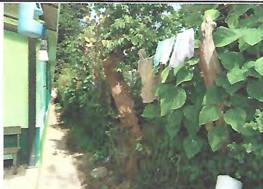
Foto 2: VULNERABILIDAD DEL MURO PERIMETRAL DEL ESTABLECIMIENTO
