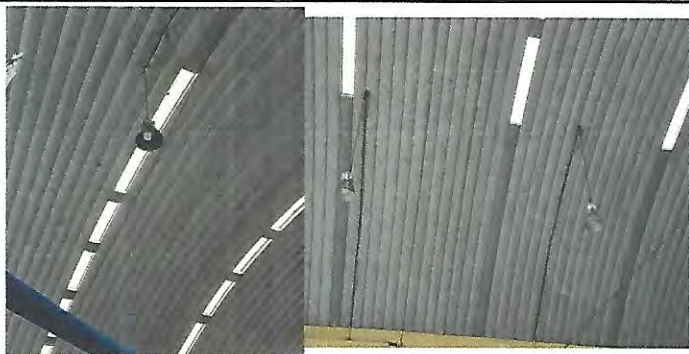
Foto1: Cambio de focos de lámparas de domo
