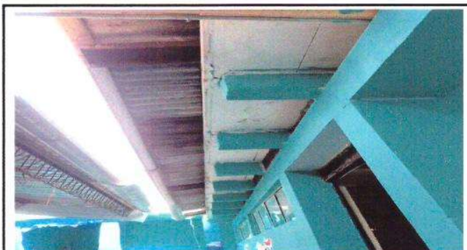
Foto 4: las láminas que se aprecian fueron colocadas con el proposito de evitar las goteras en el area de terraza, es por ello que se necesita el colocar una capa de semento en parte de arriba.
