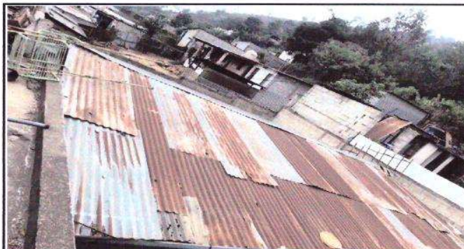
Foto 2: reparación y proteccion de terraza area de direccion 8.50.3.70, debido a que las laminas tapan los agretamientos de la loza.
