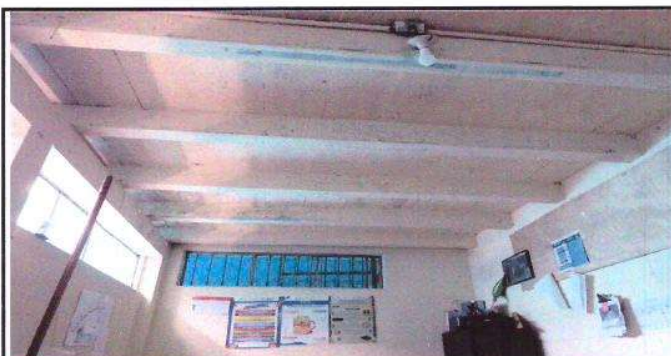
Foto 3: esta es el area de adentro de la dirección la cual tiene filtración de agua por la parte de arriba en epoca de invierno, tal como se puede apreciar en la imagen
