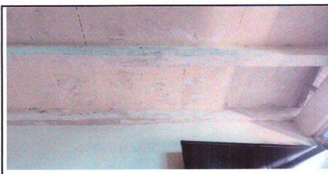
Foto 5: es mucha la filtración que se esta descascarando por el area de adentro por tanta humeada
