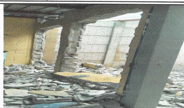
Foto 2: Pared derrumbada para ampliar salón
