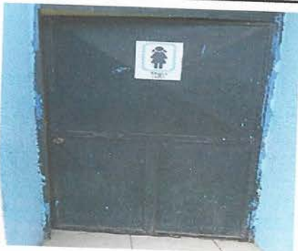
Foto 1: Puertas de salones y sanitarios dañados
