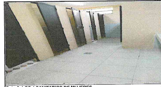
Foto 6: LOS 4 SANITARIOS DE MUJERES.
