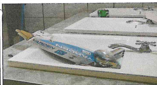
Foto 3: LAVAMANOS DEL SANITARIO DE HOMBRES.
