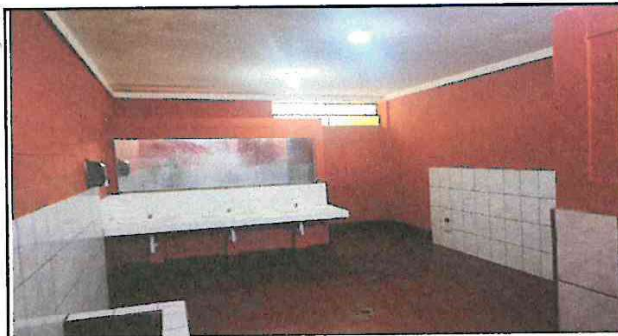
Foto 3: LAVAMANOS DEL SANITARIO DE HOMBRES.
