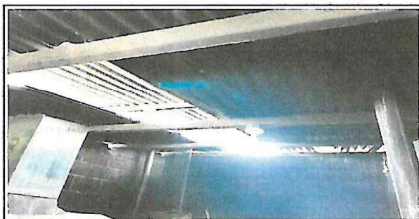
Foto 3: Modulo A: Abertura central y filtración de agua
