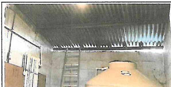
Foto 5: Modulo A: Abertura y filtración de agua.
