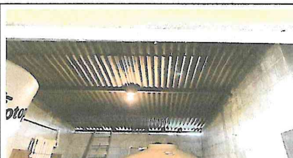
Foto 4: Modulo A: Techo de bodega de agua en mal estado.
