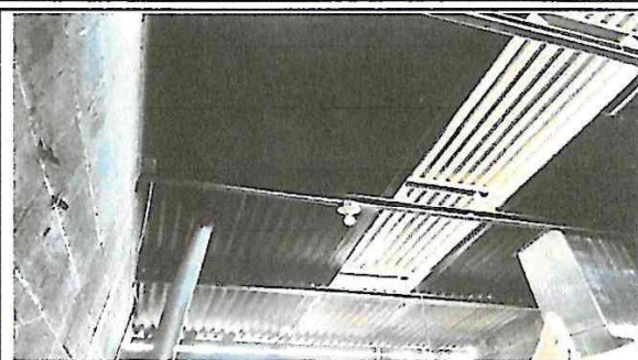
Foto 2: Modulo A: Chimenea en mal estado.
