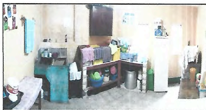
Foto 6: Humedad en área de cocina, falta mueble, ventilación no adecuada.
