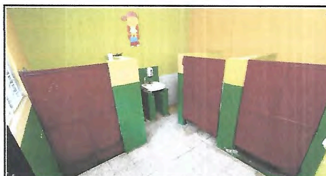
Foto 4: Daños en baños de niñas, pintura, puertas, piso, azulejo, drenaje, baños.
