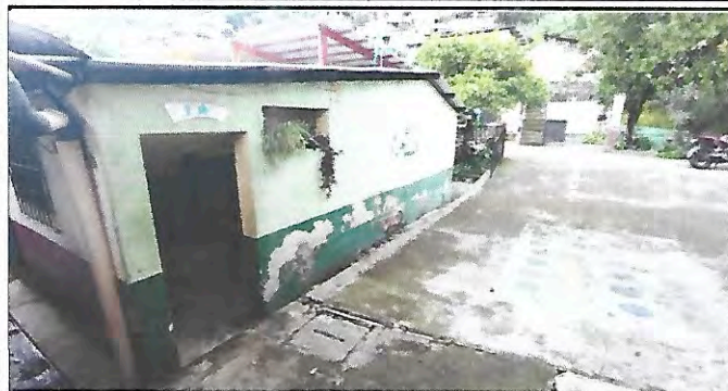
Foto 1: Daños en baños de niñas en el exterior
