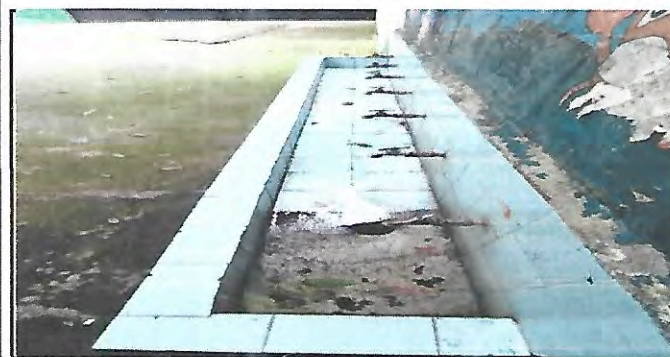
Foto 5: pileta en mal estado, azulejo, drenaje, chorros.
