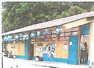
Foto 4: láminas que se desinstalarán e instalarán para corrección de goteras
