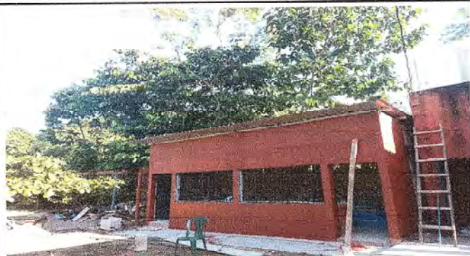
FOTO 13: Se observa la necesidad de pintura en la pared.
