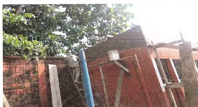
FOTO 8: Repello de muro de cocina
