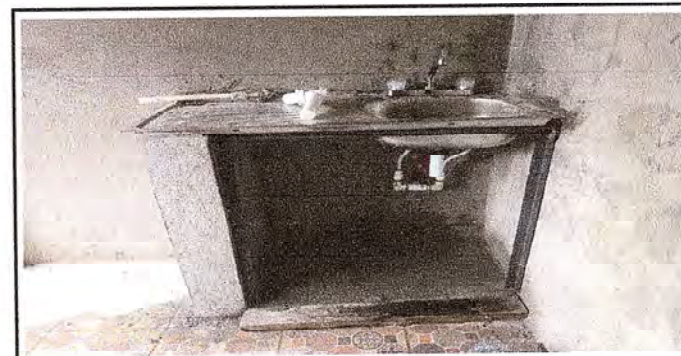
FOTO 6: Sustrucción de lavatrastos de cemento en mal estado por lavamano de metal.
