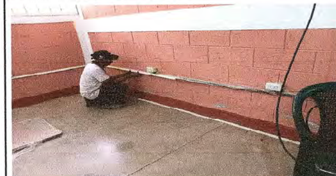
FOTO 16: Se observa el arreglo del sistema eléctrico.
