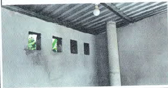
FOTO 1: Se observa el tubo de concreto en deterioro
