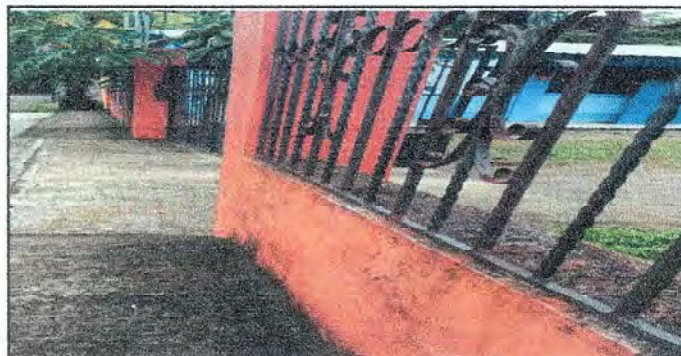
FOTO 10: Se observa el mal estado de balcones
