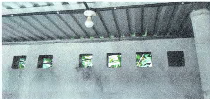
FOTO 7: Se necesita montaje y desmontaje de estructura metálica + techo de lamina.
