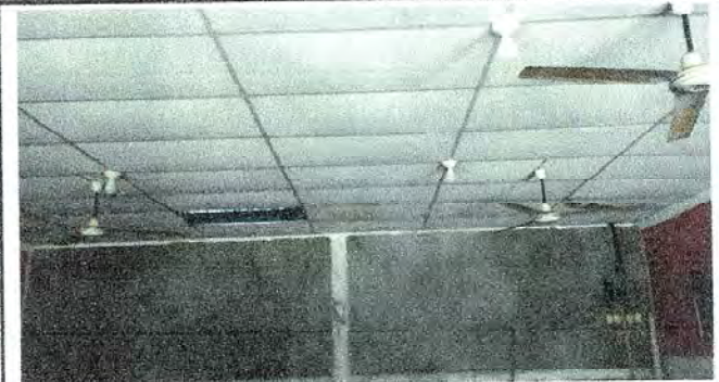
FOTO 16: Se observa el mal estado del sistema eléctrico
