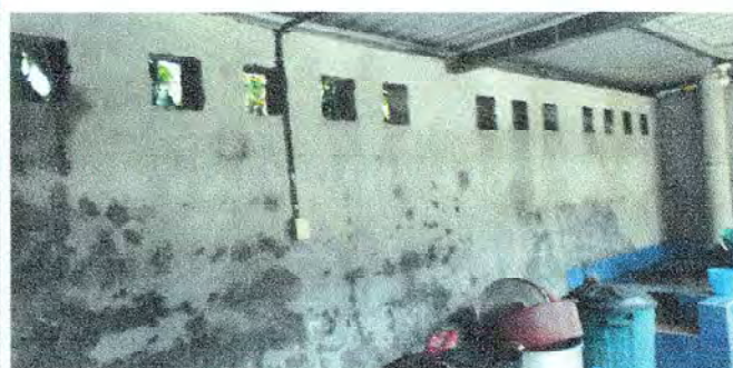
FOTO 8: Se observa el estado de muro, se necesita repello
