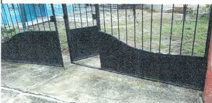
FOTO 11: Se observa el mal estado, se necesita mantenimiento en porton
