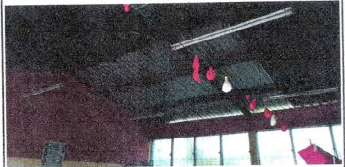
FOTO 14: Se necesita cambio de lamina
