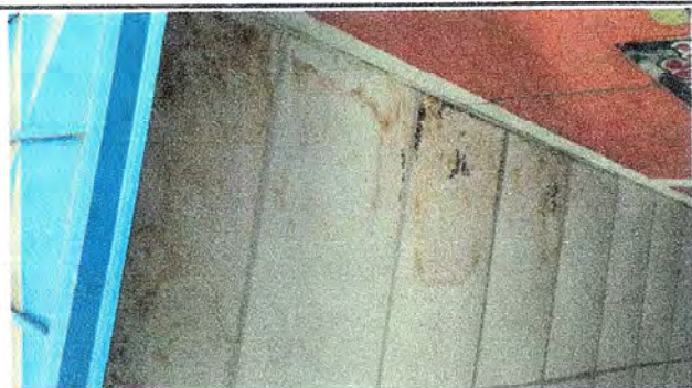
FOTO 17: Se observa el deterioro del cielo falso, urge sustitución.
