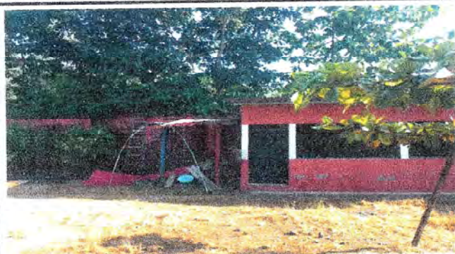
FOTO 13: Se observa que necesita aplicación de pintura en pared.
