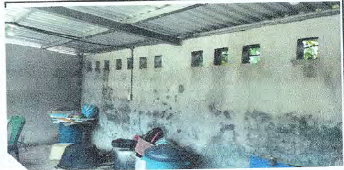
FOTO 4: Se observa que la pared esta muy baja, se necesita mejorar.
