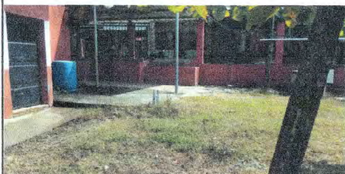
FOTO 9: Se observa la falta de línea principal de agua y drenaje
