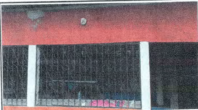
FOTO 3: Se observa la falta de malla en balcones
