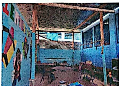
Foto 7: FOTOGRAFIA DEL ESTADO ACTUAL DEL AULA
