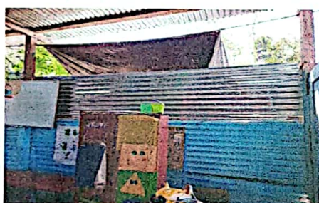
Foto 9: FOTOGRAFIA DEL ESTADO ACTUAL DEL AULA
