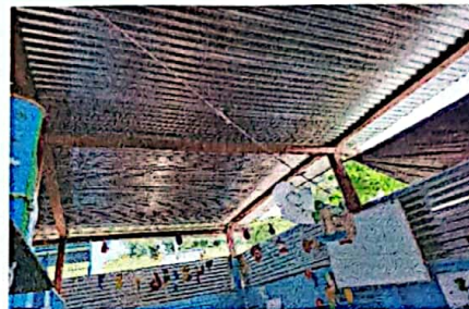
Foto 8: FOTOGRAFIA DEL ESTADO ACTUAL DEL AULA
