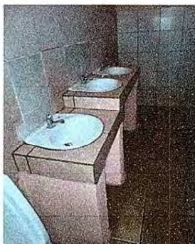
Foto 3: Sustrucción del lavamanos en mal estado.
