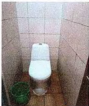
Foto 1: Sustrucción de los inodoros.
