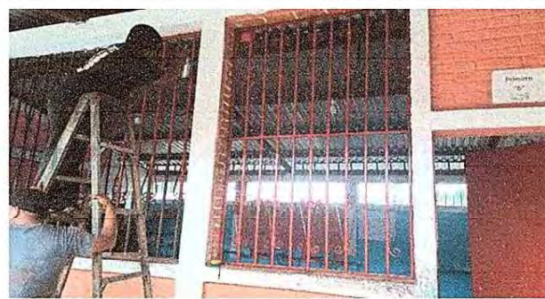
Foto 10: Pintado de balcones en mal estado
