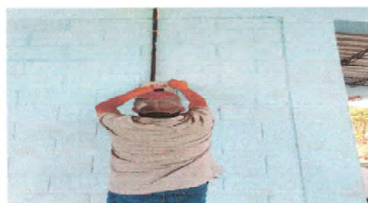
Foto 4: Se observa ampliación de sistema eléctrico escenario
