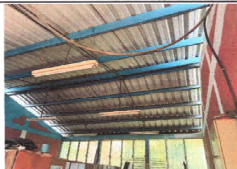
Foto 4: Se observa sistema eléctrico para reparación.
