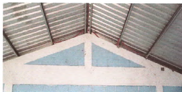
Foto 2: Se observa la necesidad de implementar luminarias y sustituir otras.
