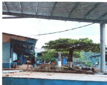
Foto: Se observa la necesidad de ampliación de línea de sistema eléctrico
