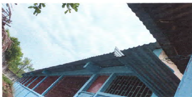
Foto 3: Se observa la necesidad canales de agua de metal y bajada de agua
