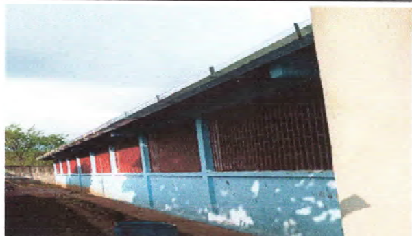
Foto 1: Se observa la necesidad implementar drenaje de agua pluvial a calle
