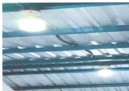
Foto 4: Sustrucción del sistema eléctrico.
