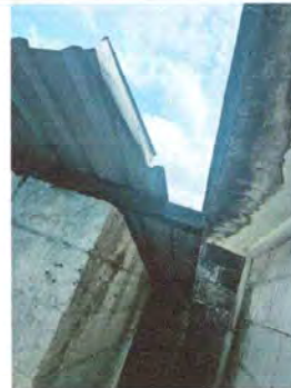
Foto 14: Se observa estructura en mal estado.
