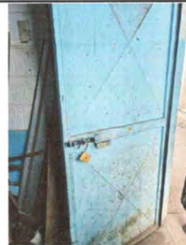
Foto 10: Se observan puertas en mal estado.
