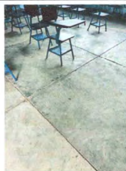
Foto 22: No se cuenta con piso cerámico.
