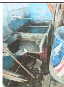
Foto 6: La pila se encuentra en mal estado.
