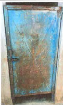
Foto 11: Se observan puertas en mal estado.
