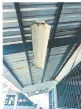
Foto 20: No se cuenta con luminarias.
