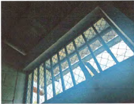
Foto 7: Se observa balcones en mal estado.
