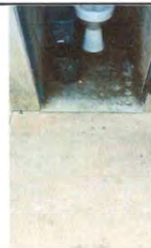
Foto 12: No se cuenta con piso cerámico.
