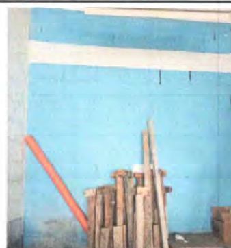
Foto 2: Se observa muro en mal estado.
