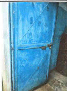
Foto 19: Se observan puertas en mal estado.
