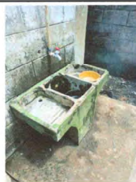
Foto 16: Se observa pila deteriorada.
