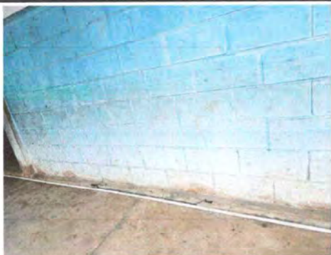
Foto 21: Se observa pintura en mal estado.
