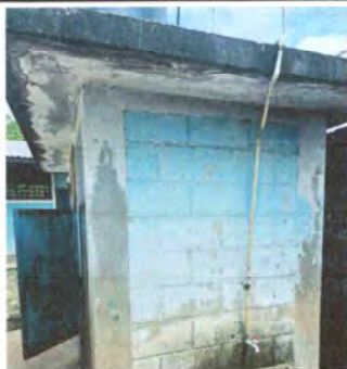
Foto 13: Se observa pintura en mal estado.
