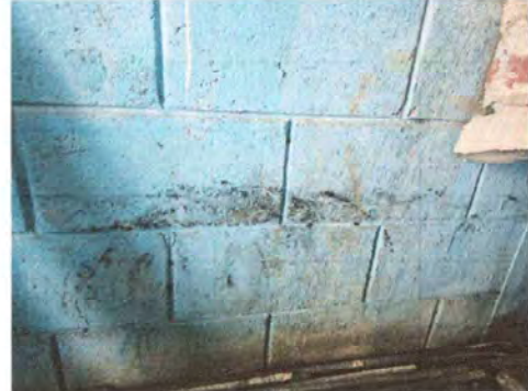
Foto 8: Se observan paredes manchadas.
