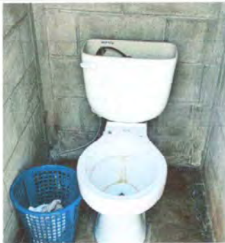
Foto 9: Se observa inodoros en mal estado.
