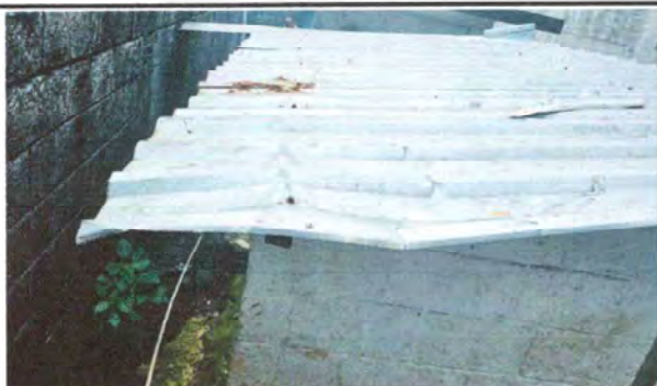
Foto 15: Se observa láminas que ya no sirven.
