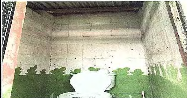
FOTO 14: Se observa el mal estado de las paredes por falta de azulejo.
