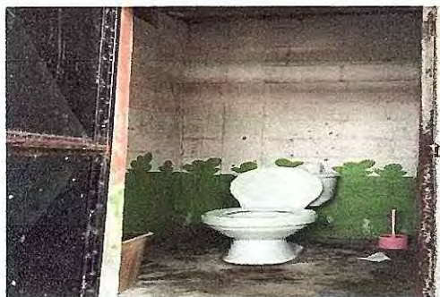
FOTO 15: Se observa el piso rustico , urge cambio a piso antideslizante.
