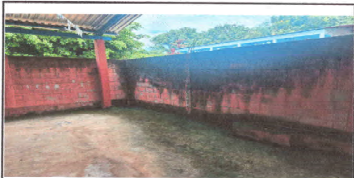
Foto 12: Se observa el mal estado del muro.
