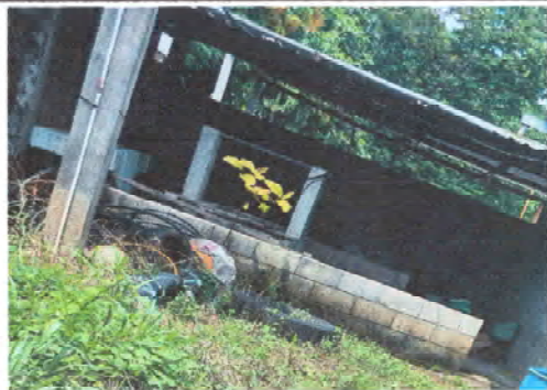
Foto 3: Se necesita mejorar muros de cocina
