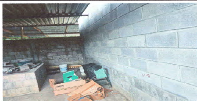
Foto 6: Se observan paredes sin pintura.
