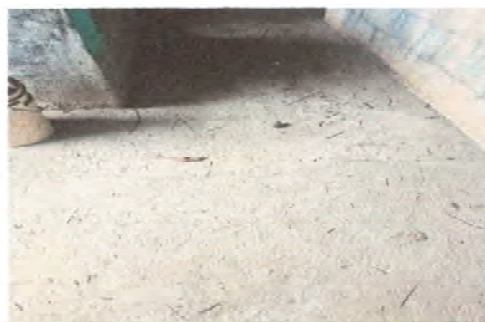
Foto 4: Se observa que piso existente necesita mejoras.
