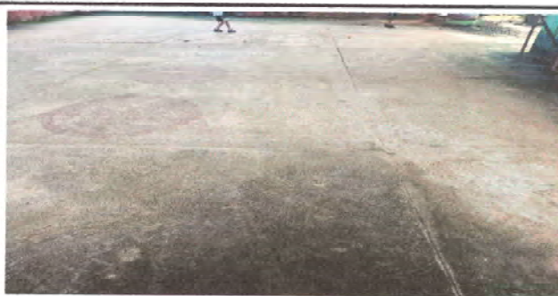
Foto 11: Se observa que el piso necesita mejoras.
