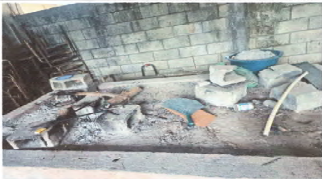
Foto 1: No se cuenta con estufa en funcionamiento, se necesita sustituirla.
