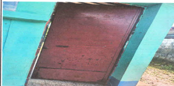
Foto 8: Se observa el mal estado de puertas.
