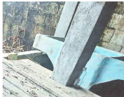
Foto 2: Se observa que pila actual se encuentra en mal estado.
