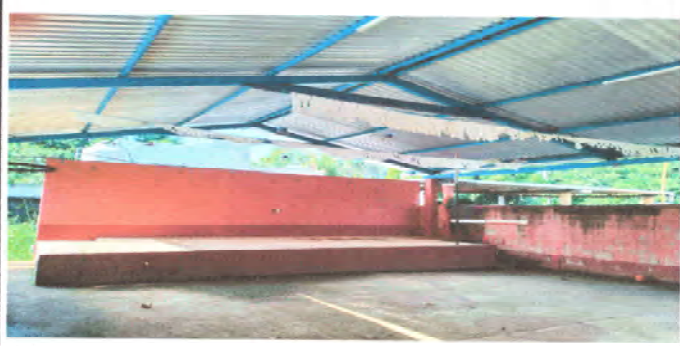
Foto 10: Se observa que pared necesita aplicacion de pintura.
