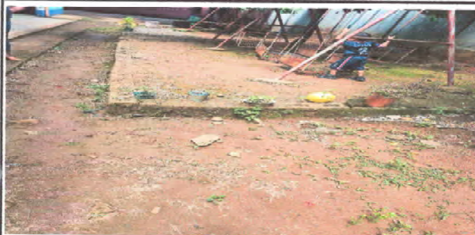
Foto 9: Se observa la necesidad de suministrar torta de concreto en patio.
