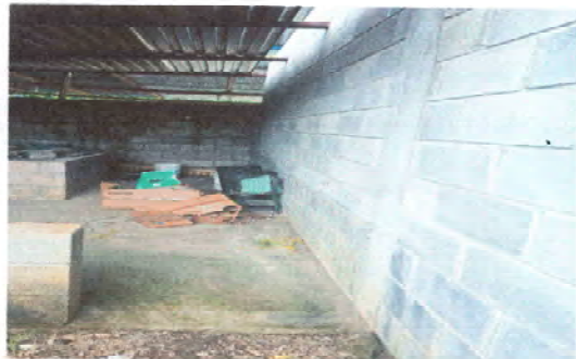
Foto 7: Se observa que la cocina carece de una puerta.
