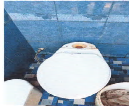
Foto 8: Se observa el cambio de accesorios de sanitario, por deterioro y fuga de agua.
