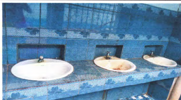
Foto 9: Sustrucción de llaves
