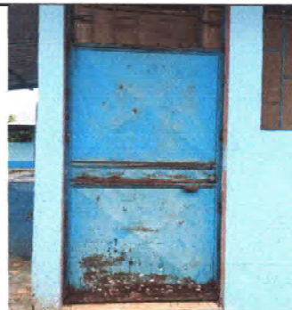
Foto 4: Se observa puertas en mal estado (cocina)
