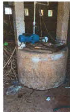
Foto 8: Se observa la necesidad del matenimiento al pozo.
