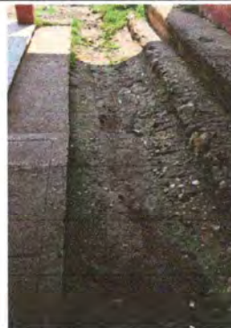
Foto 2: Se observa en mal estado la cuneta de concreto.
