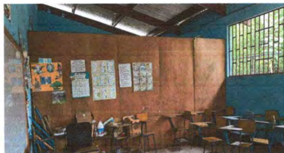
Foto 4: Se puede verificar el deterioro del entrepaño.
