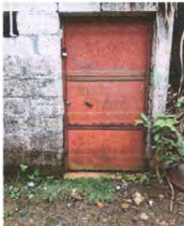
Foto 7: Se observa la necesidad de susitución de la puerta de metal.
