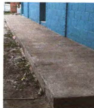
Foto 8: Se puede observar el levantamiento de la banquetta que se encontraba en mal estado.
