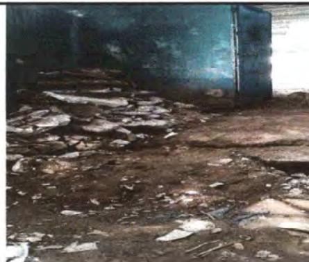
Foto 8: Se puede observar el levantamiento de la banqueta que se encontraba en mal estado.
