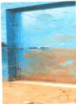
Foto 3: Se observa que el mal estado de la puerta
