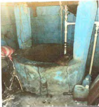
Foto 9: Se observa el mal estado del pozo
