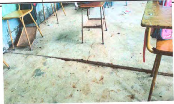
Foto 2: En módulo 7 se observa el mal estado del concreto
