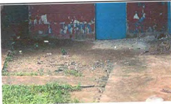
Foto 5: Se observa el mal estado de la torta de concreto
