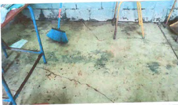
Foto 1: Se observa que el piso en módulos se encuentra en mal estado
