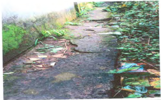
Foto 4: Se observa el mal estado de banqueta
