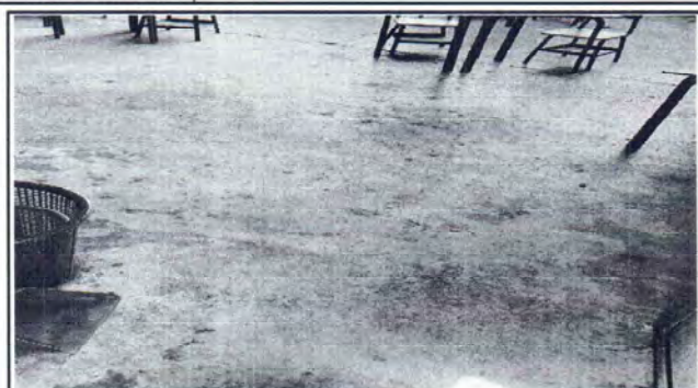
Foto 1: Se observa en mal estado del piso.
