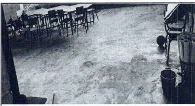
Foto 6: Se observa el mal estado del piso.
