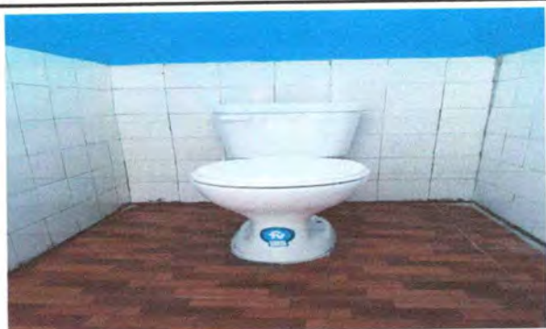
Foto 3: El asulejo quedó en buenas condiciones.
