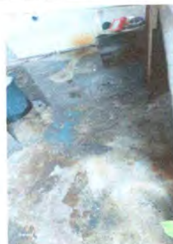
Foto 2: Los sanitarios no tienen piso cerámico.
