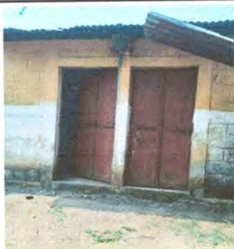
Foto 7: Las puertas externas de los sanitarios están en mal estado.
