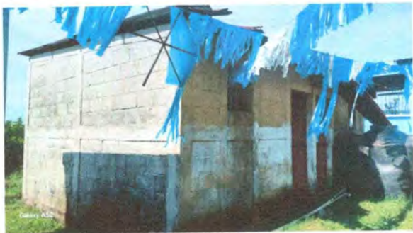
Foto 1: Las paredes de los sanitarios no están repelladas.
