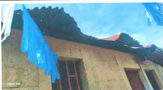
Foto 9: El techo de los sanitarios está inservible.
