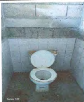
Foto 3: El azulejo se encuentra en mal estado.
