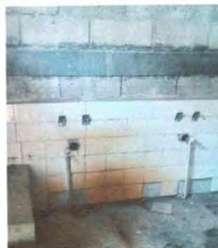
Foto 4: No se cuenta con lavamanos.
