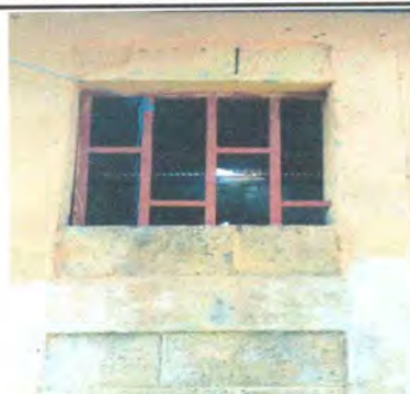
Foto 8: Los balcones están en mal estado.
