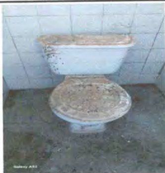
Foto 5: Los inodoros están en mal estado.
