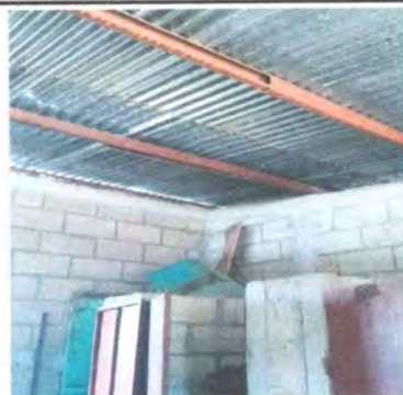
Foto 10: La estructura de soporte del techo de los sanitarios está en mal estado.
