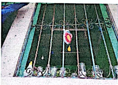
Foto 9: FOTOGRAFIA DEL ESTADO ACTUAL DE LOS BALCONES
