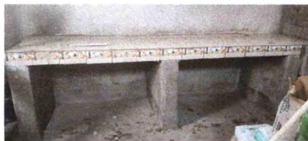
Foto 14: Se observa el banco de trabajo instalado.
