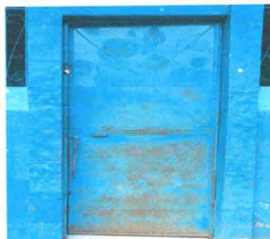
Foto 4: Se observa que las puertas necesitan mantenimiento
