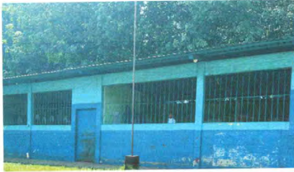
Foto 13: Se observa la necesidad de aplicar pintura
