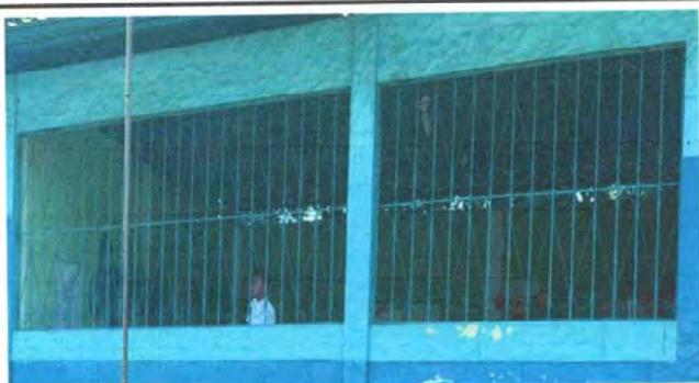
Foto 3: Se observa que los balcones necesitan mantenimiento
