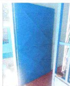
Foto 11: Se observa como quedo la puerta
