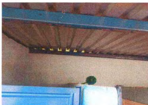
Foto 15: Se observa como quedo la estructura de metal
