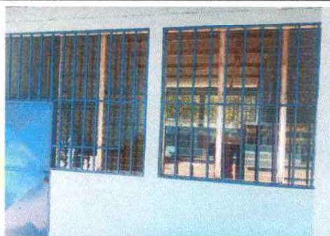
Foto 9: Se observa como quedo la ventana
