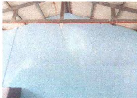
Foto 2: Se observa como quedo el repello del muro
