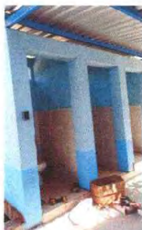
Foto 13: Se observa la necesidad de colocar azulejo
