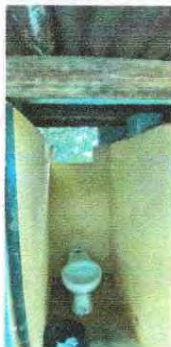
Foto 13: Se observa la necesidad de colocar azulejo en los baños
