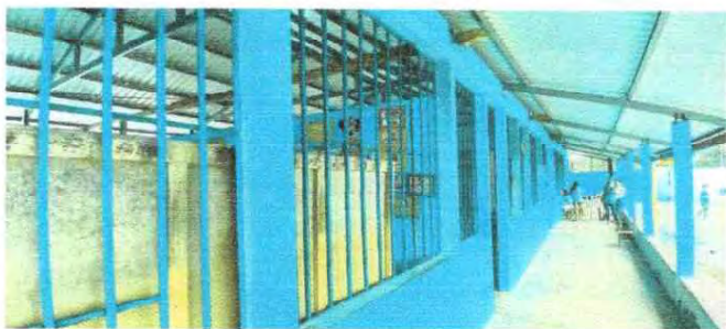
Foto 9: Se observa la necesidad de colocar ventanas
