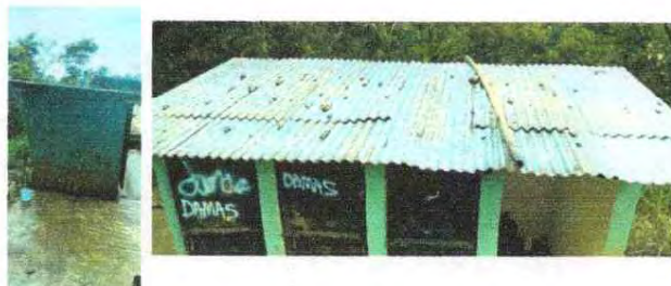
Foto 16: Se observa la necesidad de aplicar pintura en muros
