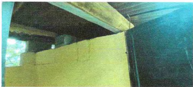
Foto 15: Se observa el mal estado de la estructura de soporte
