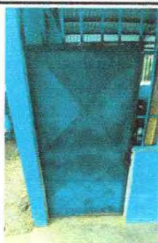
Foto 11: Se observa que la puerta necesita mantenimiento
