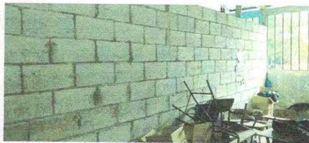
Foto 2: Se observa la necesidad de aplicar repello en los muros
