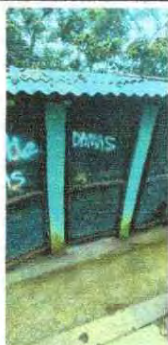
Foto 17: Se observa el mal estado de la puerta
