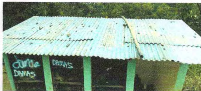
Foto 14: Se observa la necesidad de sustituir la lamina existente
