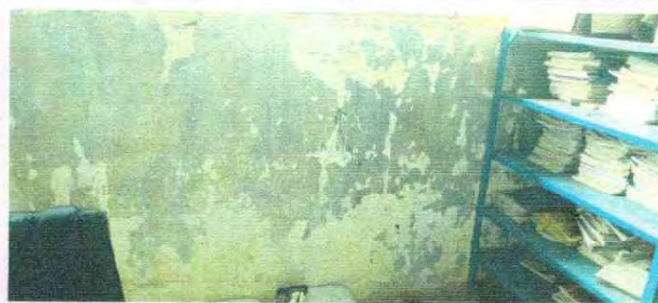
Foto 8: Se observa la necesidad de aplicar pintura en los muros
