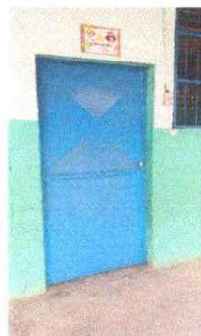
Foto 2: Se observa como quedo la puerta
