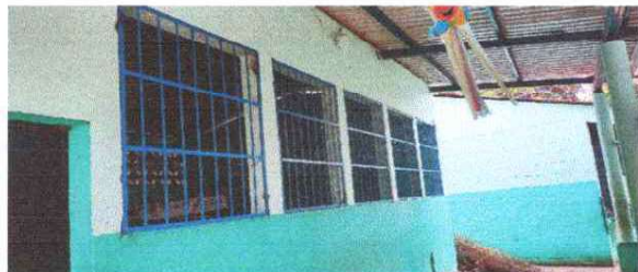
Foto 1: Se observa como quedaron los balcones
