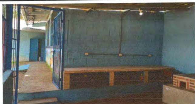
Foto 5: Se observa como quedo el sistema eléctrico
