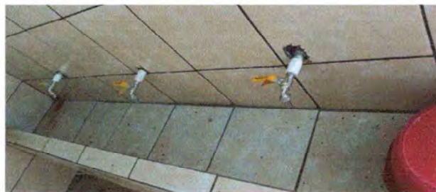
Foto 11: Se observa el cambio de los chorros en mal estado
