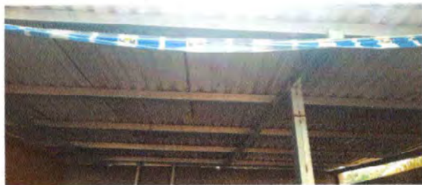
Foto 5: Se observa la necesidad del sistema eléctrico
