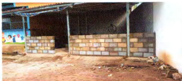
Foto 2: Se observa la necesidad de balcones de metal
