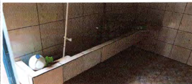
Foto 12: No se cuenta con agua para los baños por lo que se necesita la tubería principal
