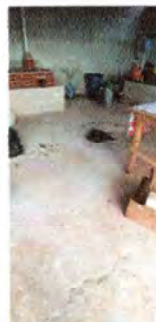
Foto 8: Se observa la necesidad de piso ceramico
