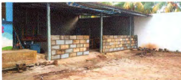
Foto 6: Se observa la necesidad de colocar puertas
