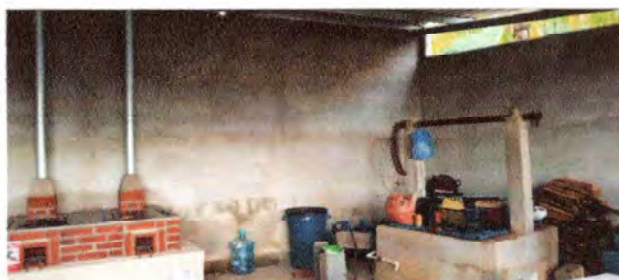
Foto 16: Se observa la necesidad de aplicar pintura en los muros
