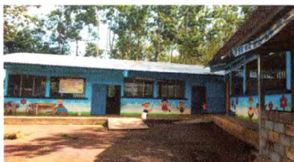
Foto 13: Se observa la necesidad de colocar canales para la agua
